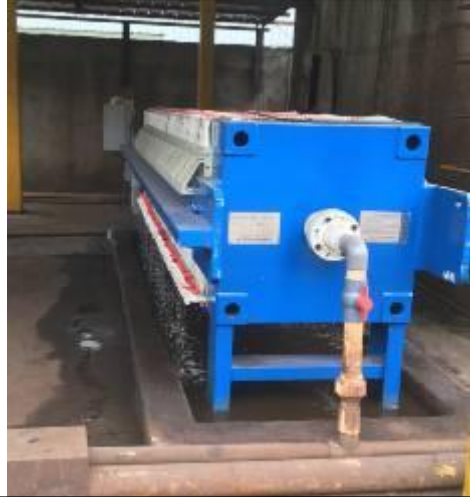
废水处理设施局部
