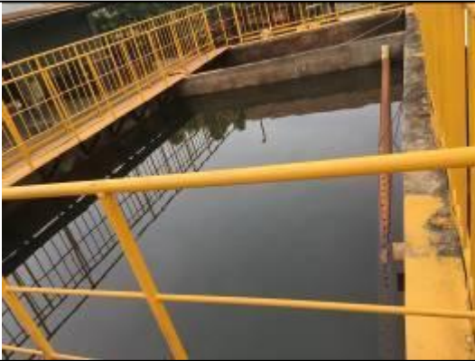
废水处理设施局部
