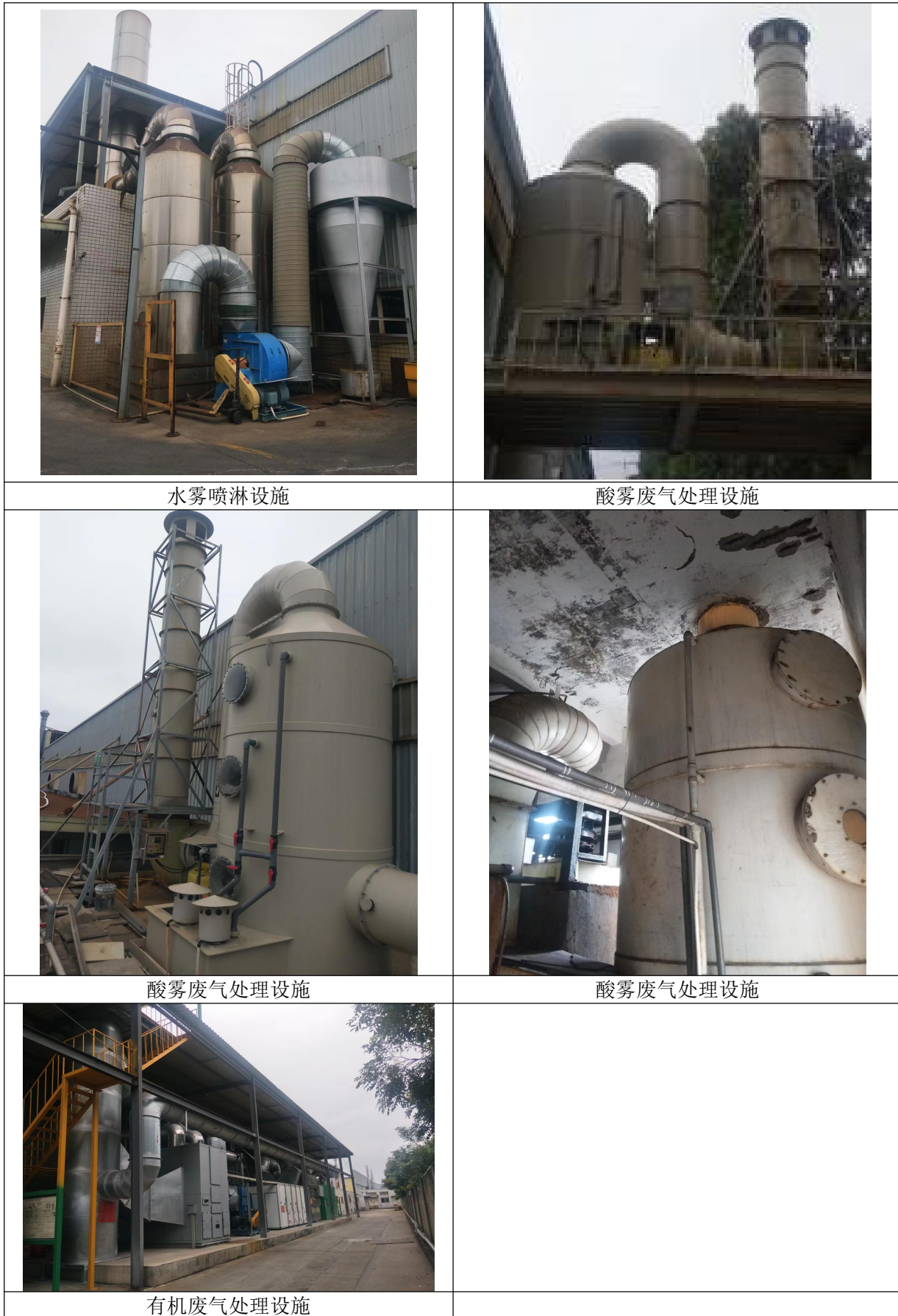
图3-9 废气处理设施现场图
