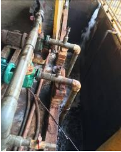
废水处理设施局部
